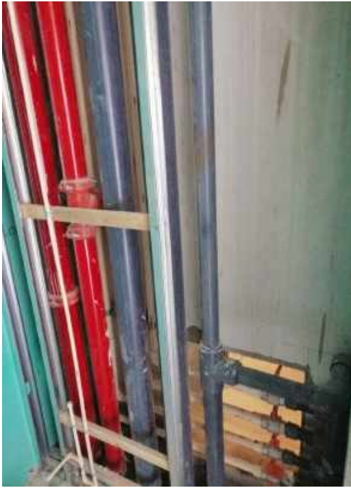
Inst. Hidrante Nivel 17
